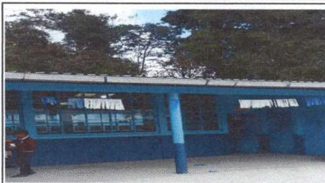
Foto 2: Repello de paredes por hongo.
